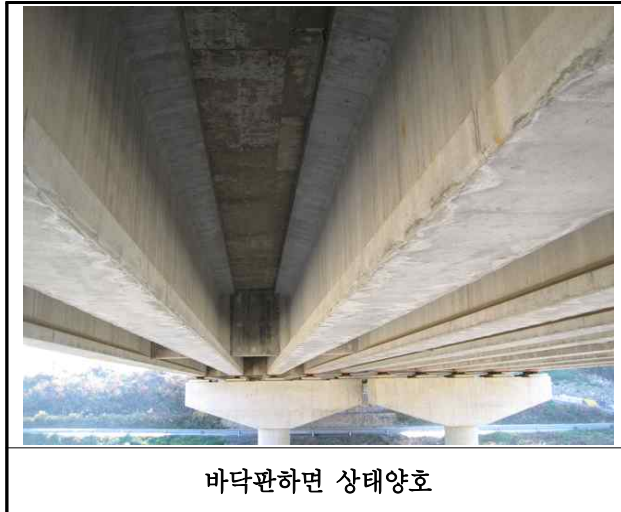
【사진 17.3.26】 바닥판하면 손상현황
