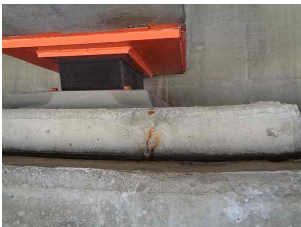
A2-Sh2 반침콘크리트 들뜸 및 철근노출 (0.1m×0.1m)
