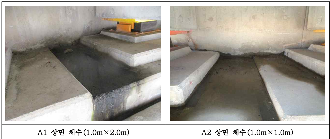
【사진 17.3.9】 교대 손상현황
