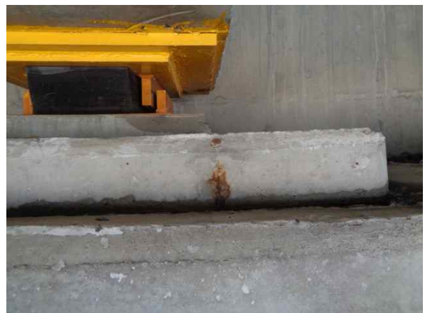
A2-Sh3 반침콘크리트 들뜸 및 철근노출 (0.1m×0.1m)
