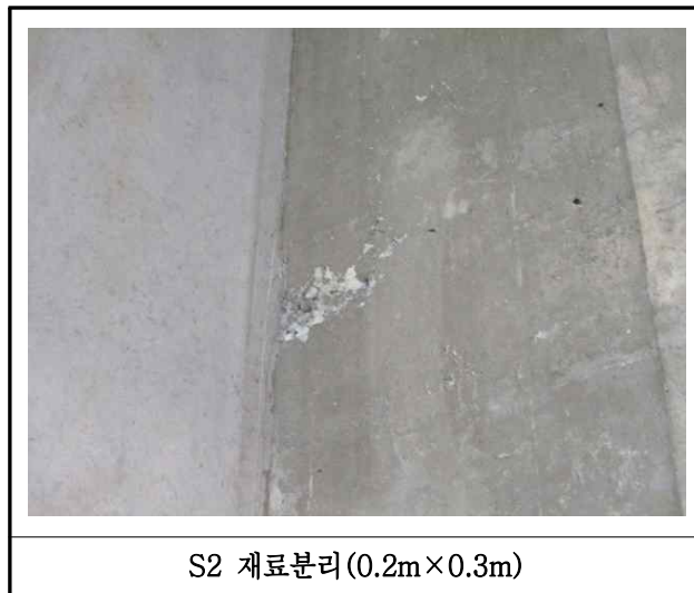
【사진 17.3.7】 가로보 손상현황
