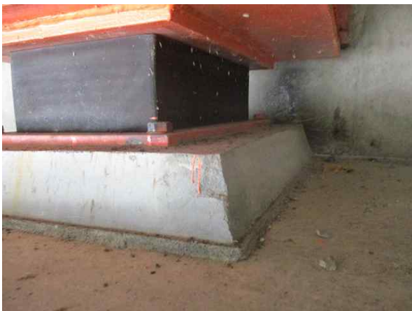
A1-Sh1 무수축물탈 파손(0.1m×0.1m)
