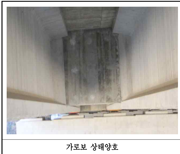
【사진 17.3.30】 가로보 손상현황
